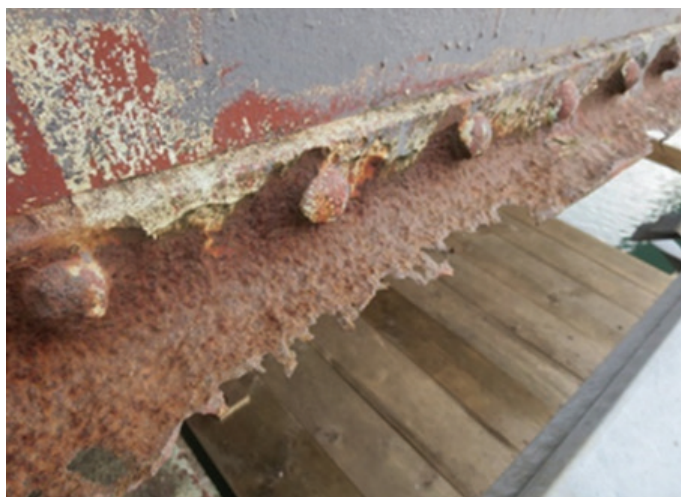
Slika 2 • Korozijske poškodbe spodnjega dela konstrukcije.
