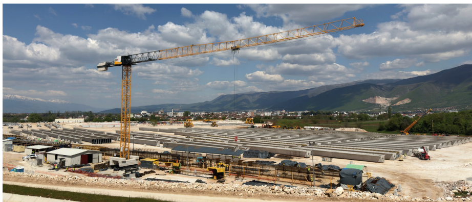
Slika 8. Prefabrikacijski obrat za izdelavo betonskih elementov (v Srbiji so bili v času največje ekspanzije del vzpostavljeni trije takšni obrati, v Severni Makedoniji sta trenutno dva)
