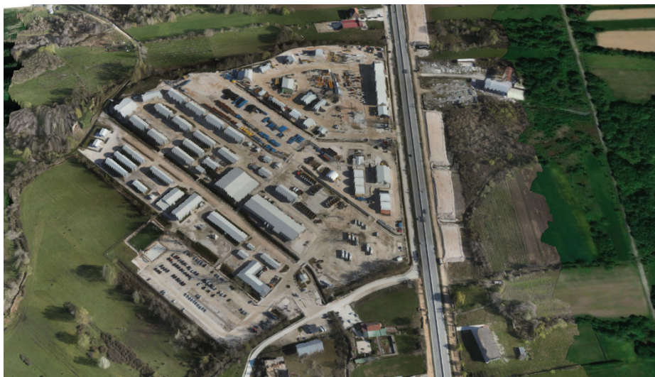
Slika 7. Nastanitveni gradbiščni kompleks za zaposlene v Severni Makedoniji. Tako v Srbiji kot v Severni Makedoniji sta vzpostavljena dva takšna kompleksa za zaposlene
