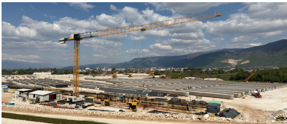
Slika 8. Prefabrikacijski obrat za izdelavo betonskih elementov (v Srbiji so bili v času največje ekspanzije del vzpostavljeni trije takšni obrati, v Severni Makedoniji sta trenutno dva)
